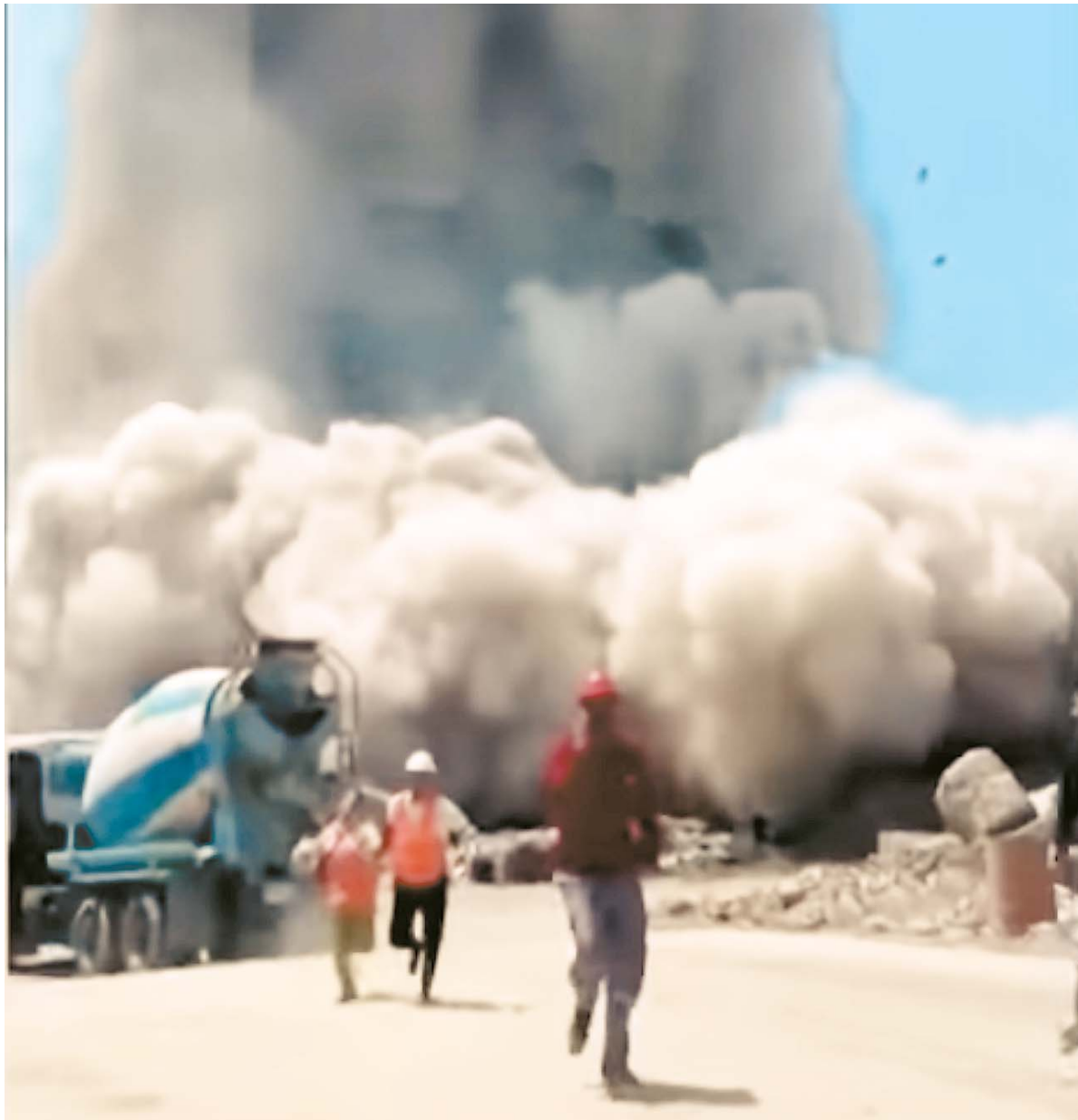
Em segundos, o prédio foi reduzido a um emaranhado de escombros e metal retorcido
